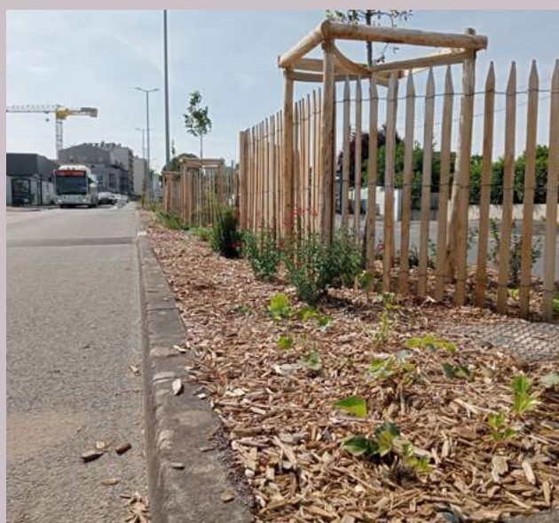
Élément de maçonnerie délimitant la voirie des espaces végétalisés, mais qui empêche l'écoulement des eaux de pluie vers les plantations. / Maxime Dépinoy, Plante & Cité
