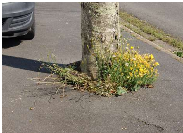
Végétaux se développant à la jointure entre le pied d'un arbre et un enrobé. / Robin Dagois, Plante & Cité
